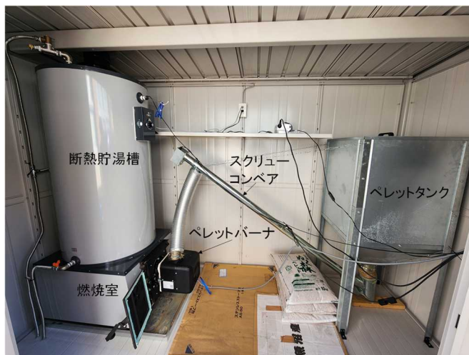
図2 学内に設置したバイオマスボイラ実機
