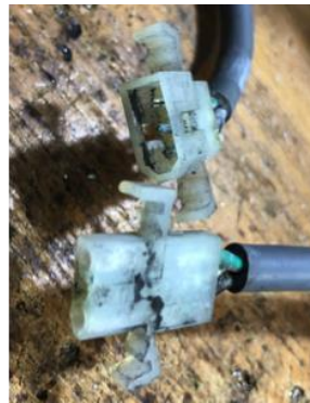
写真2 腐食したコネクタ
