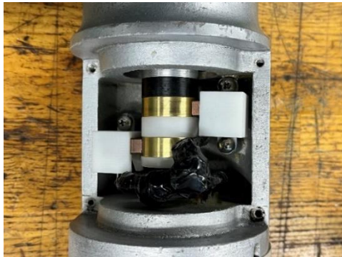
写真4 整備後のスリップリング部
