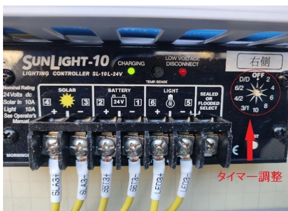
写真 7 充放電コントローラー
