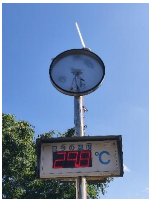
写真10 故障中の時計1
