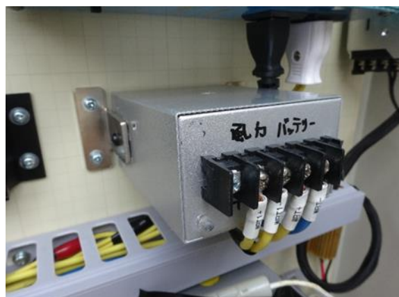
写真6 充電用コントローラー
