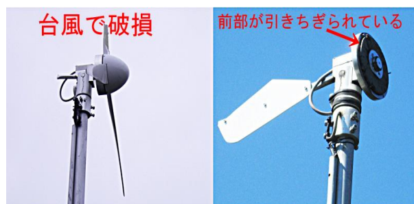
写真4 台風で破損した風力発電機
