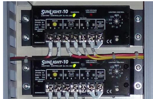
写真4 ソーラー充電コントローラー
