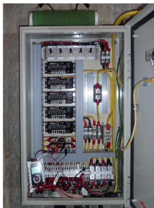
写真9 風力・太陽光発電 入力制御盤
