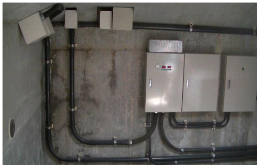
写真5 制御盤外観の一部 (旧)
