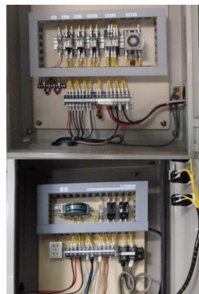
写真11 リレーシーケンス・ 商用切替盤
