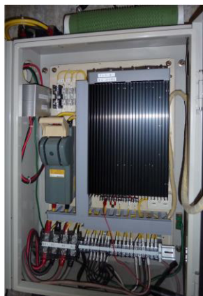
写真10 インバータ・メー ターリレー盤
