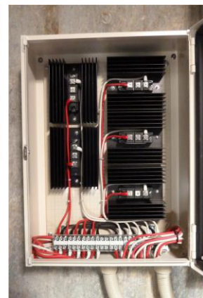
写真12 ダイオード盤
