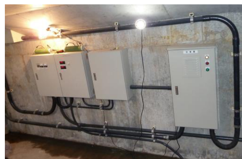
写真6 制御盤外観全体 (新)
