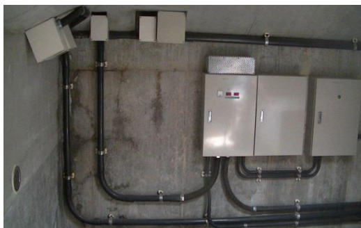
写真4 制御盤全体外観
