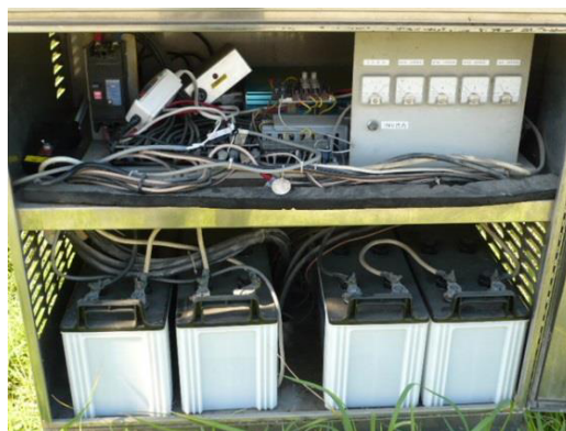
写真3 改修前制御盤内
