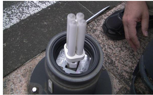
写真9 照明器具内部
