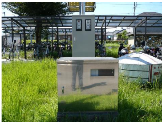
写真 8 制御盤全外観
