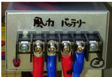
写真5 風力充電コントローラ
