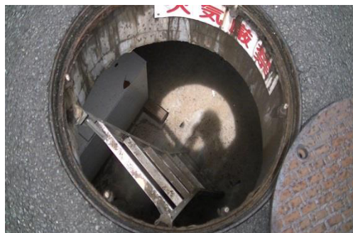
写真5 制御盤室入口
