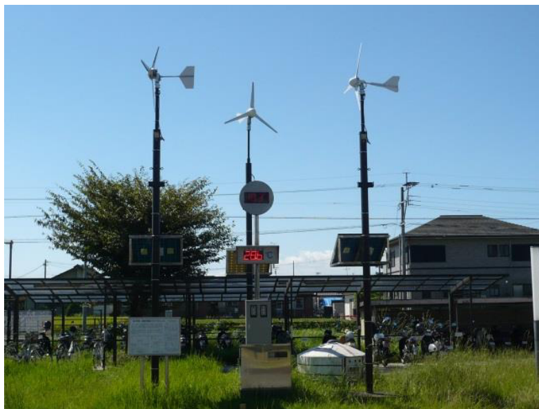
写真1 正面玄関前独立型ハイブリッドシステム
