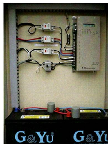
図6 制御ボックス内部
