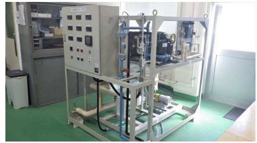
図5 冷凍機実験装置
